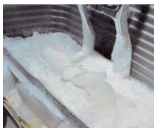
Oblodzenie urządzenia zewnętrznego bez ogrzewania tacy
